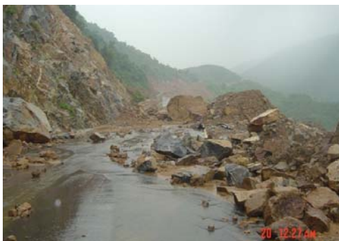
Hình 1. Ta luy đào sâu, đắp cao luôn là mối đe dọa đối với điều kiện khai thác của tuyến đường
