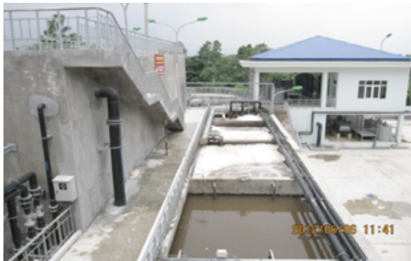
Trạm xử lý nước thải của Nhà máy
