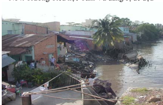
No6: Dãy nhà ở chân cầu Kinh bị sụp xuống sông
