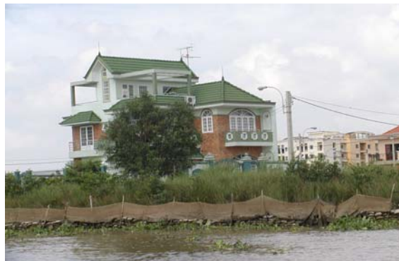
No2: Bờ kè ở Thảo Điền - Quận 2 đang bị đe dọa
