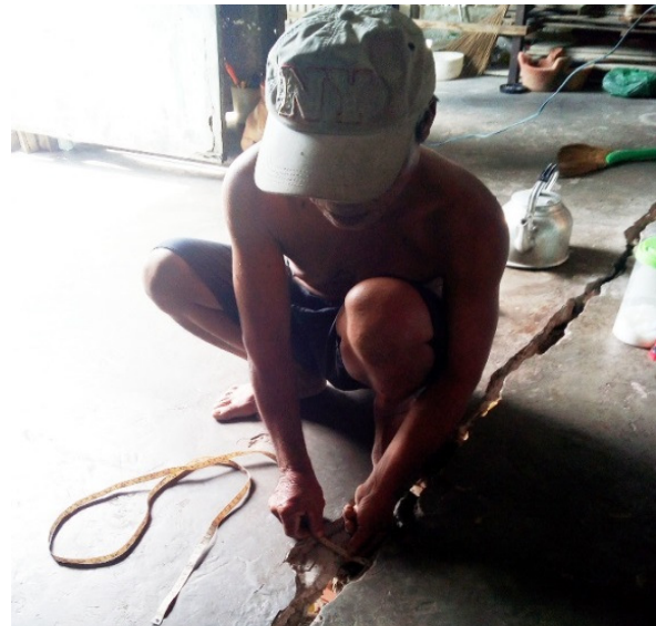
Hình 4. Nền nhà bị nứt sau đó lún sụt tại thị xã Giá Rai tỉnh Bạc Liêu, ngày 27/6/2017 (Ảnh Chi cục PCLB Bạc Liêu).
