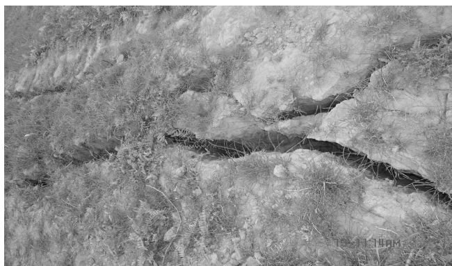
Ảnh 1: Cung trượt tại K22+260 đến K22+280 Đoạn Tuyến Suối vớt nết rặng 15 đến 20 cm, nằm ngay sát chân đê do tiếp xúc trực tiếp đến an toàn của đê.
