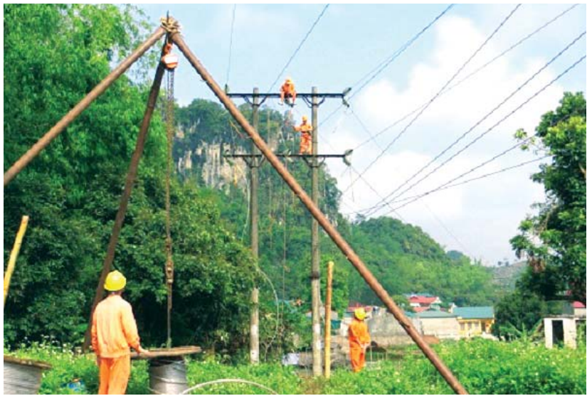
Ở các huyện miền núi Phú Thọ, phụ tải điện thường phân tán, hiệu quả kinh tế thấp, điện chủ yếu phục vụ dân sinh. Ảnh: Công ty Điện lực Phú Thọ
